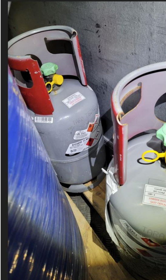
Flere gassflasker sammen med brannfarlig væske.jpeg
