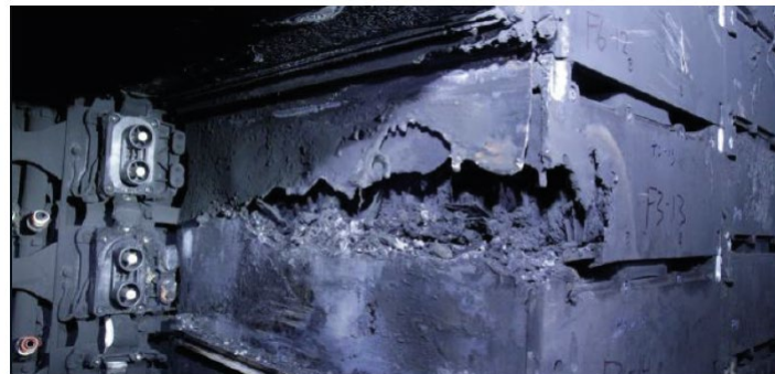
Fra DSBs veileder for brann- og redningsvesen: brann på MS Ytterøyningen ødela kapslingen i stål. Foto: Kripos
