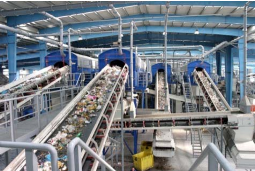
Figur 4: Figur 6- 1: Sentralsorteringanlegget på ROAF. Bildet er hentet fra Kretsløpet.no
